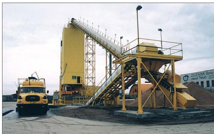
Obr. 1 Přeprava štěrku – betonárka Brno (využití frekvenčního měniče VQFREM 400)
