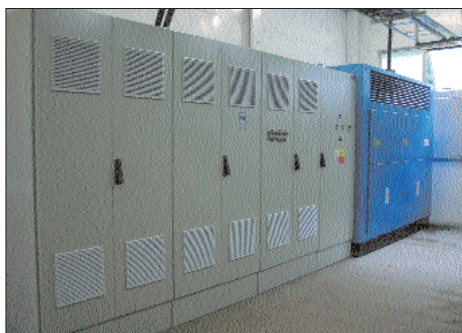
Obr. 2 Komplexná dodávka VONSCH s frekvenčným meničom VQFREM 690 V – 1,2 MW
