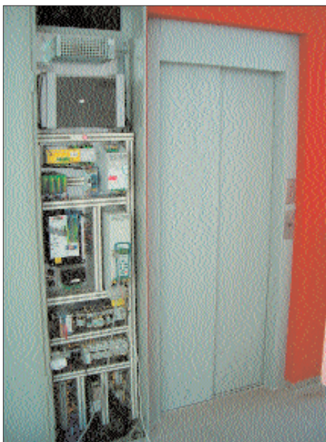
Obr. 5 Riešenie pohonu výťahu v hoteli (hore: záložný zdroj UPS, stred: VQFREM 230 E – regulácia otvárania dverí, dole: VQFREM 400 – regulácia posuvu kabíny)
