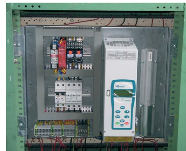
Obr.4 Montážna doska v pôvodnom rozvádzači
