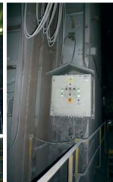
Kompletný rozvádzač s meničmi a výstavou
