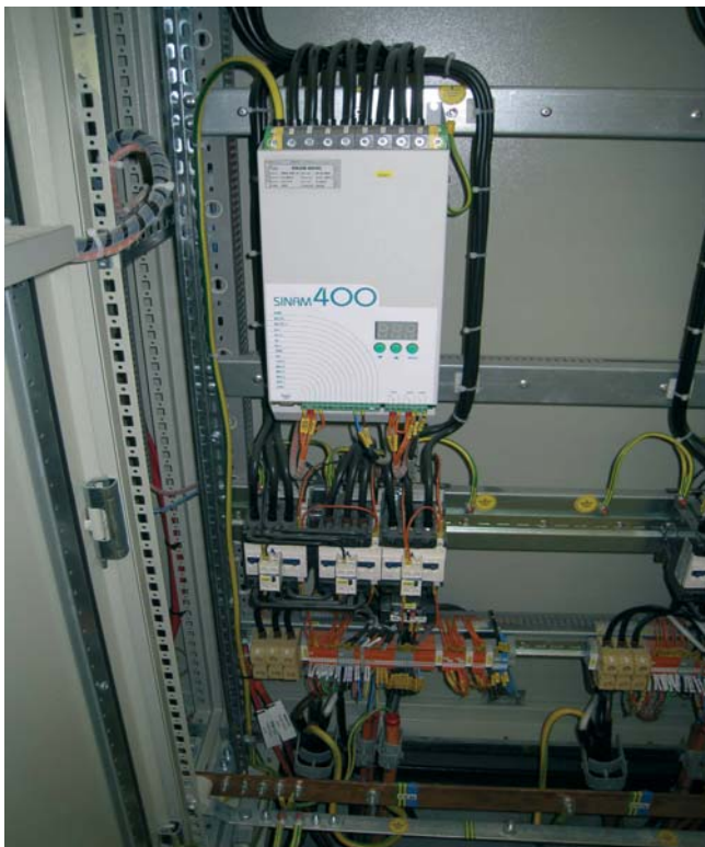
Softštartér inštalovaný v rozvádzači
