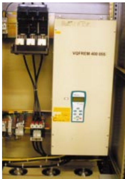
Frekvenčný menič VQFREM 400 pre výkon motora 55 kW v skriní rozvádzača (NN rozvodňa)
